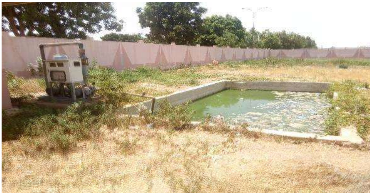
Photo 4 : Station de traitement des eaux usées y compris les DBM liquides en pannes
