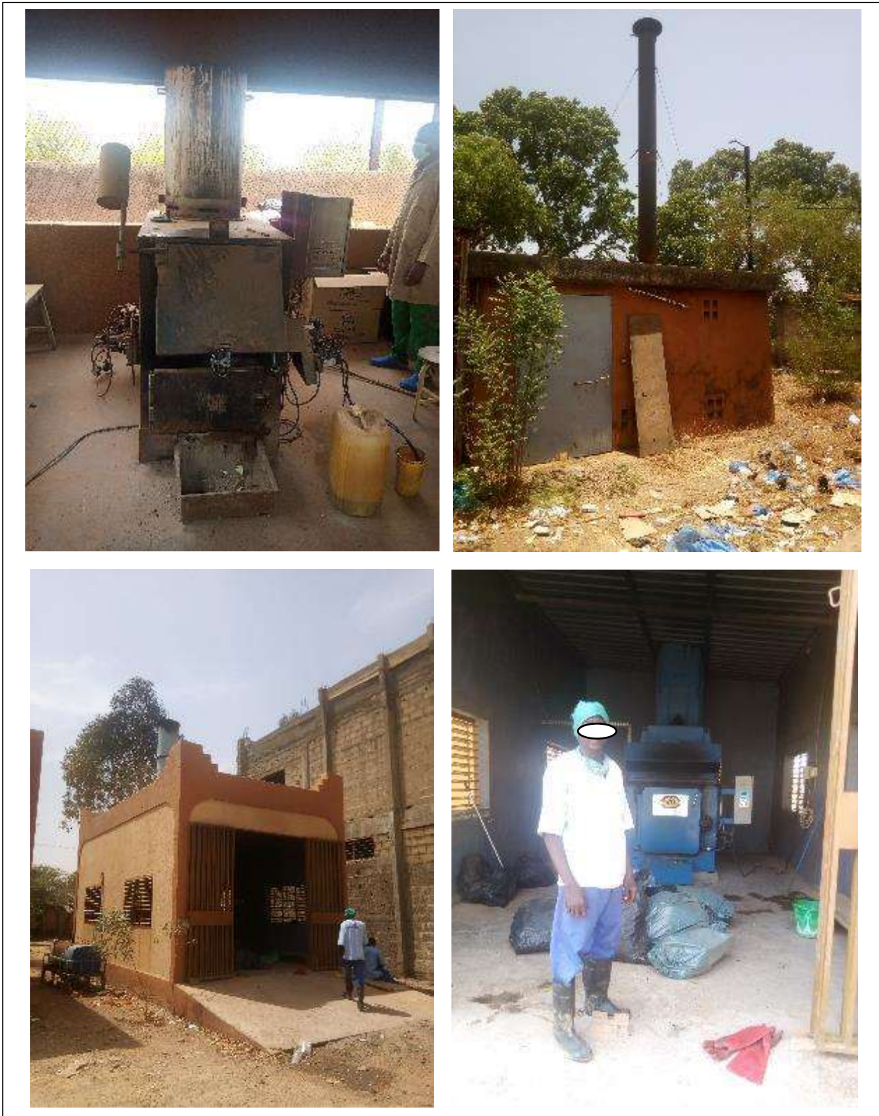
Photo 5 : Incinérateurs en panne ou non adaptés dans les établissements de santé
