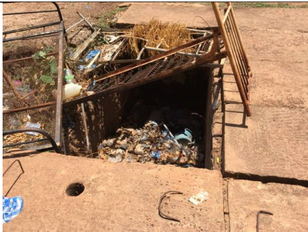
Photographie 12 : Fosse septique servant de vidoir pour le sang et autres déchets liquides de la maternité du CM/ Koudougou
